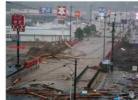
平成24年7月出水の状況 (玉来川 桜瀬橋付近)
