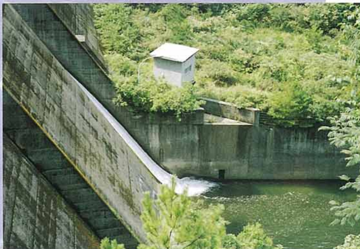
放流管・放水管バルブ施設
