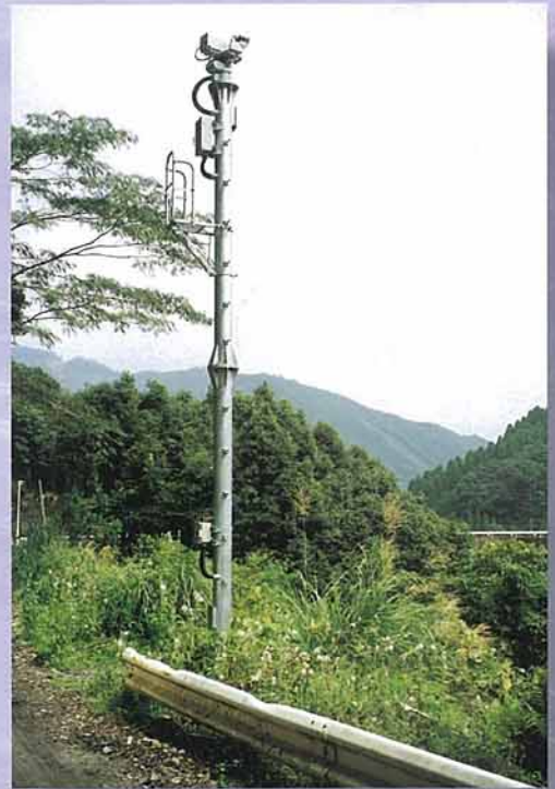
ダム監視カメラ
