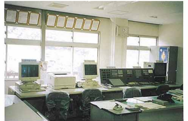
ダム管理事務所遠方操作設備
