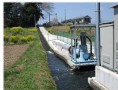
城原井路発電所(竹田市)
