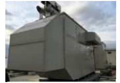
非常用発電装置
