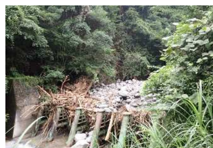
草木川の土砂・流木捕捉状況 (令和5年梅雨前線豪雨)
