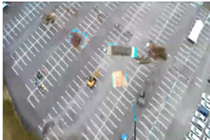
ドローンによる被災現場のリアルタイム撮影
