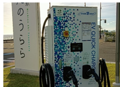
道の駅におけるEV充電機器
