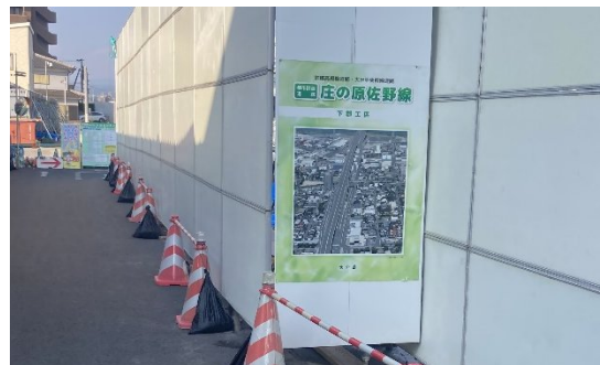
工事現場における完成予想図の掲示 ( (都)庄の原佐野線:大分市)
