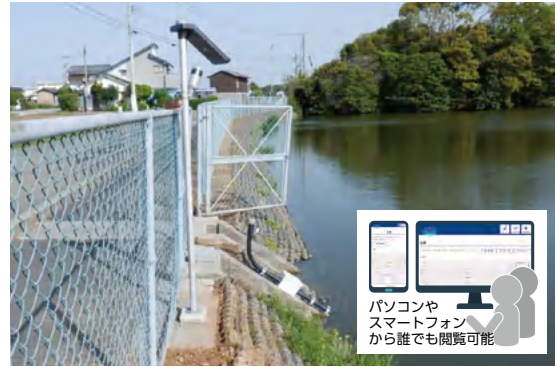
ため池の保全管理に向けた監視カメラ等の整備
