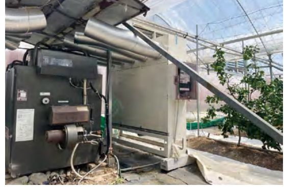
園芸ハウスに導入した環境にやさしい省エネ暖房 (ヒートポンプ)
