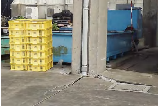
地震による被害が生じた荷さばき施設
