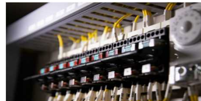
電装事業（配電盤等）に特化
