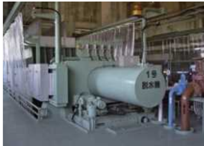
加圧脱水機(汚泥処理設備)
