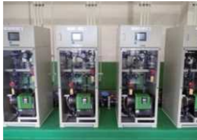
薬品注入ポンプ
