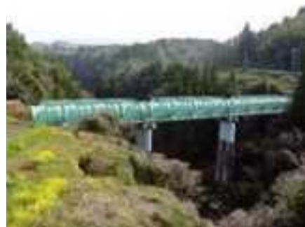
三重川水管橋
