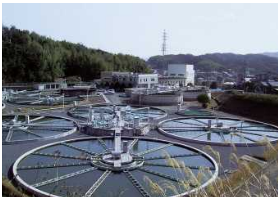
判田浄水場（大分市）
