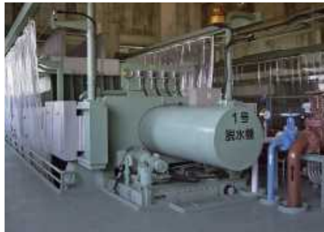
加圧脱水機(汚泥処理設備)
