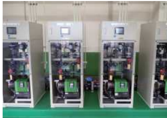
薬品注入ポンプ
