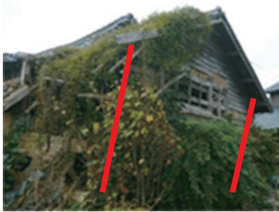
建物の傾斜が1/60以上…30点
