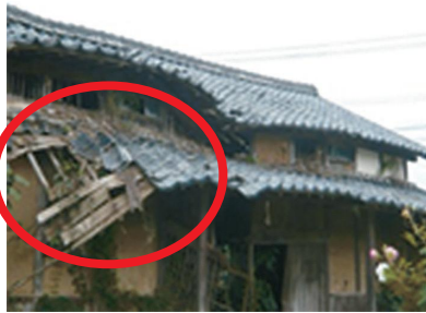
屋根材の飛散の恐れがある…40点
