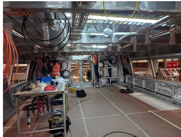
電気設備艙装
