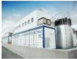
系統安定化のための蓄電池
