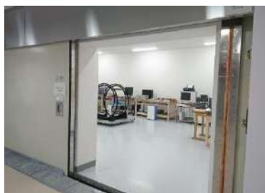
大型磁気シールドルーム
