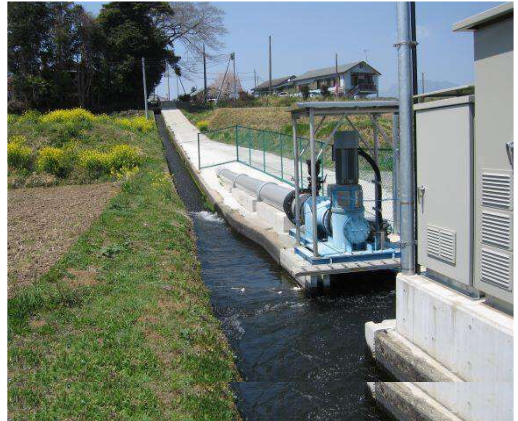
城原井路発電所(竹田市)
