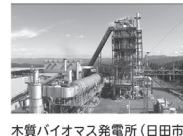
木質バイオマス発電所(日田市)
