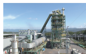
木質バイオマス発電所（日田市）
