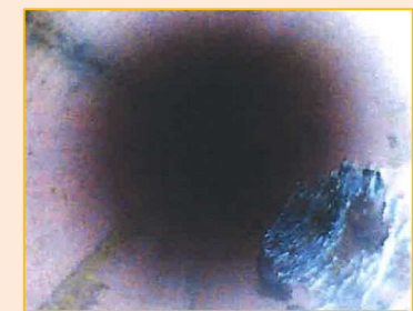
空調設備 「配管内の腐食」
