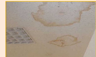
2階研修室 「天井雨漏り」
