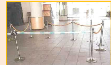
1階ロビー 「床タイル浮き」
