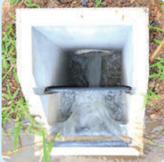
田んぼダム専用桝 (機能分離型排水桝)
