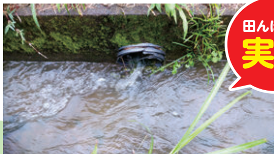
田んぼダム 実施 ほ場からの排水 (排水量が少ない)
