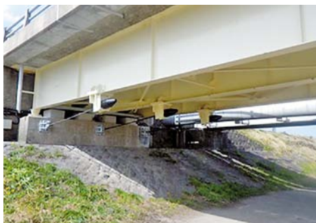
橋梁耐震化の事例
