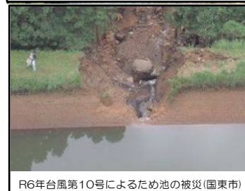
R6年台風第10号によるため池の被災（国東市）
