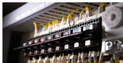
電装事業（配電盤等）に特化
