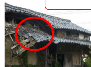
屋根材の飛散の恐れ
