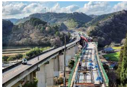
4車線化が進む東九州自動車道（宇佐IC～院内IC） （香下大橋）
