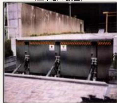
出典：国土交通省「浸水被害防止に向けた取組事例集」より引用
