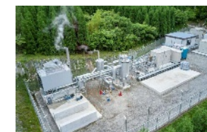
地熱発電電力を活用した水素製造実証事業（株）大林組提供
