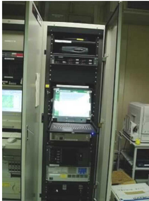
図 3.22 震動観測情報提供サーバ設置状況
