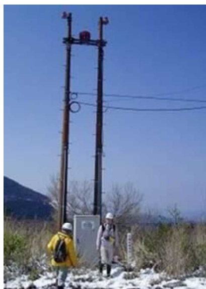
図 3.16 硫黄山警報局（モーターサイレン、パトライト）
