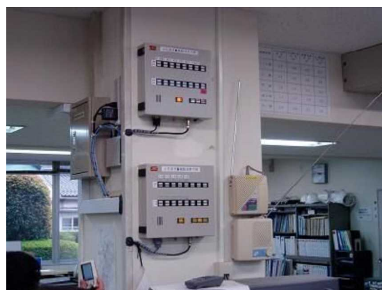
図 3.27 警報表示板 (雨量警報、検知警報)
