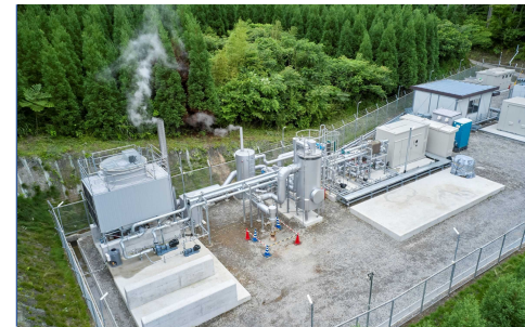
大分県産グリーン水素製造実証プラント (株)大林組
