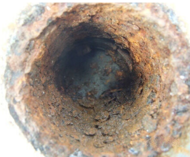
逆止弁内面ユニット側 (矢視②)
