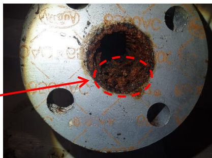
逆止弁内面ユニット側 (矢視③)
