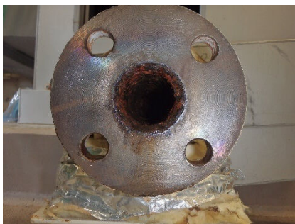
排水配管内面ユニット側
