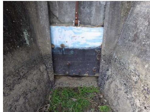
写真 2.1.2 老朽化した樋管
