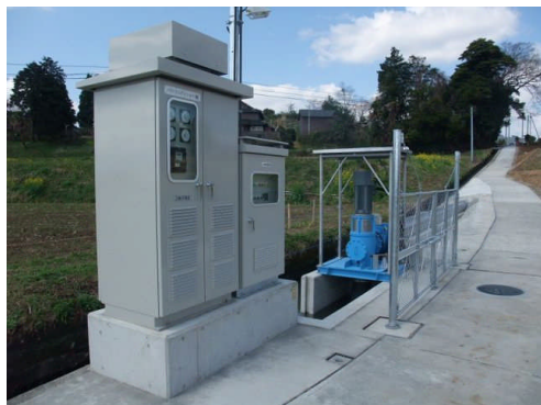
城原井路発電所（城原井路土地改良区） 最大使用流量=0.45(m 3 /s) 有効落差=7.99(m) 最大発電出力=25(kW) 運転開始年：2010年
