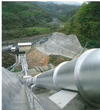
富士緒井路第二発電所（富士緒井路土地改良区） 最大使用流量=2.0(m 3 /s) 有効落差=96.62(m) 最大発電出力=1,500(kW) 運転開始年：1984年
