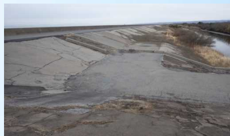
亀裂が入った堤防法面
