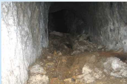
土砂が堆積した素掘水路トンネル
