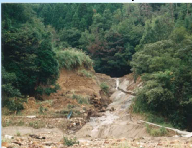
豪雨により決壊した、ため池
