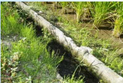
老朽化した用水路
