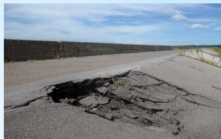
陥没した堤防
