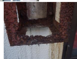
支持部が腐食していた看板の例
