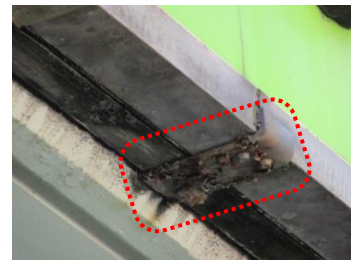
金具が劣化した状態
