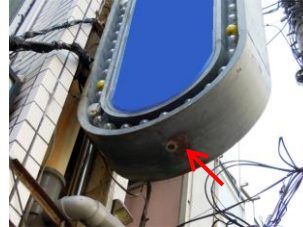
水抜き孔が詰まった状態
