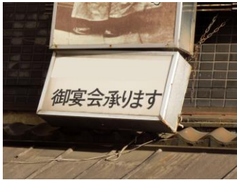
屋外広告物本体の傾き
