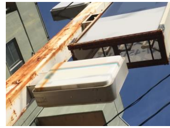
支柱にさびが発生した状態
