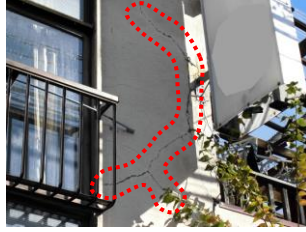
壁面にひびが生じた状態
