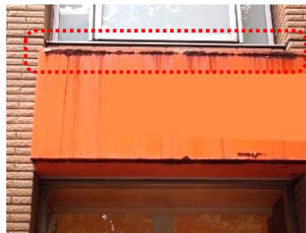
その他（塗装剥離、腐食など）
