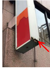
広告板底部の腐食が進行した状態
