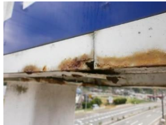
その他（塗装剥離、腐食など）
