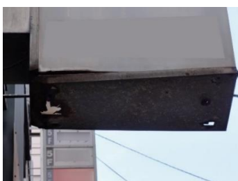
側板底面が腐食、破損、変形した状態
