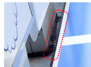
コーキングが劣化した状態
