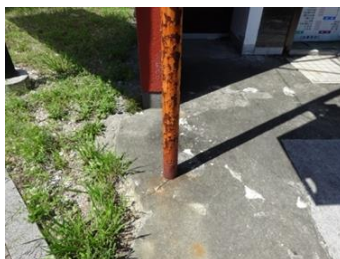
支柱の腐食が進行した状態
