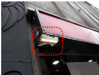
広告板底部の腐食、水抜き穴の詰まり
