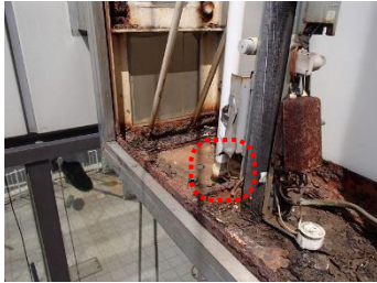
蛍光灯のホルダーが破損した状態
