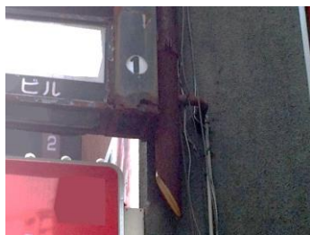
支持部が腐食した状態
