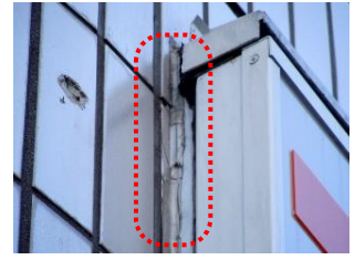
コーキングが劣化した状態
