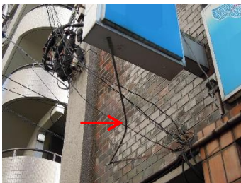
振れ止め棒が変形した状態
