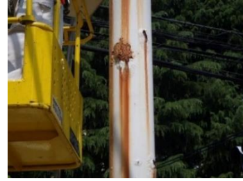
その他（支柱の腐食など）
