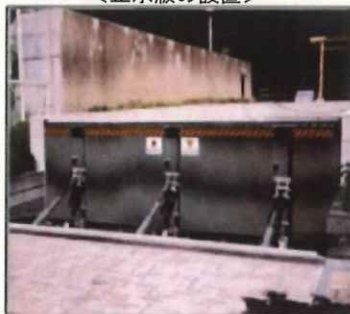
出典:国土交通省「浸水被害防止に向けた取組事例集」より引用
