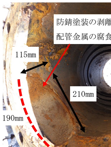
漏えい箇所内面写真
