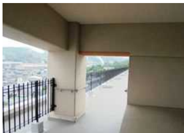
屋上避難スペース
