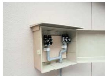
炊き出し用ガス配管
