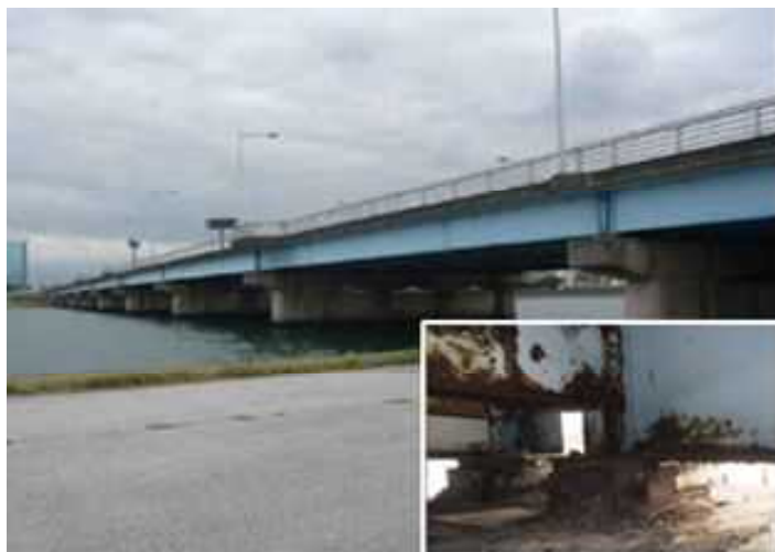
〔老朽化が進む弁天大橋（大在大分港線）〕
