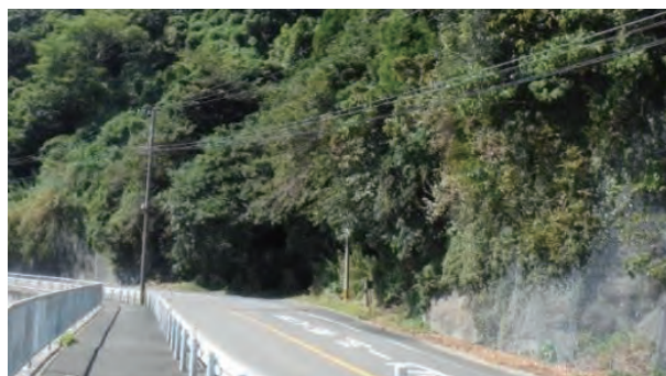
落石の恐れがある箇所でのり面対策（国道217号 佐伯市）
