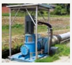
竹田市 城原井路小水力発電所
