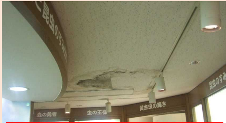
花昆虫館（天井部分の雨漏り）
