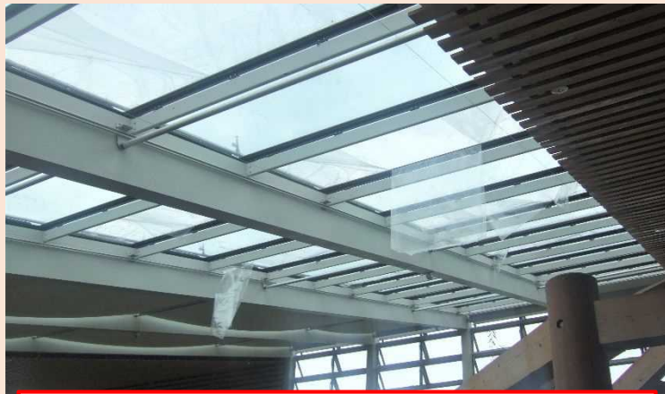
花昆虫館（天井ガラスの飛散防止シート剥離）
