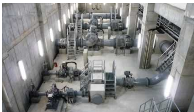
[三佐配水ポンプ]
