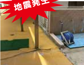
地震の被害を受けた学校
