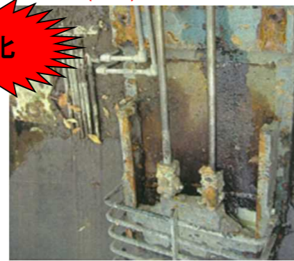
取水ゲートの油漏れが発生
