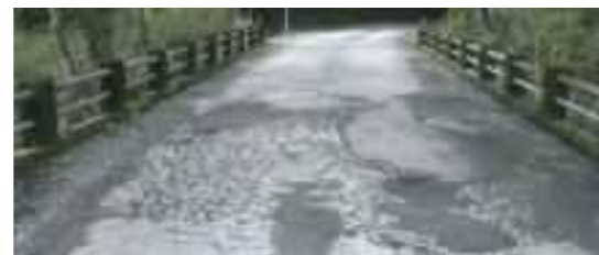
舗装ひびわれ、高欄老朽化等
