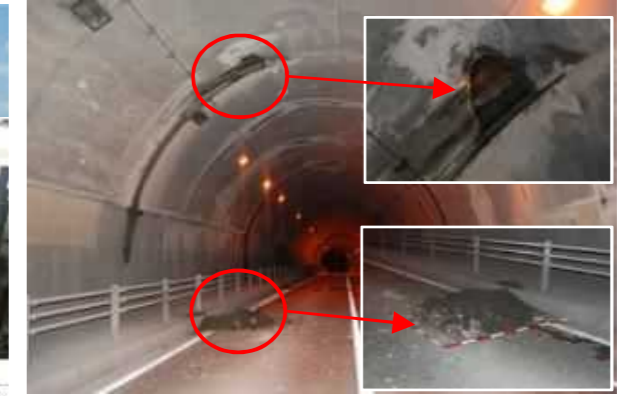
市道徳浦松崎線 下浦トンネル(津久見市) 覆工の損傷・崩落
