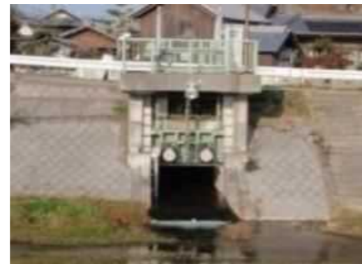
排水機場（国東市：荒木川）
