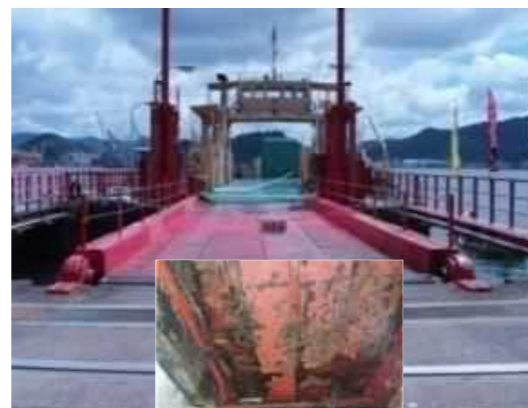
港湾可動橋の損傷状況（佐伯市：大入島）
