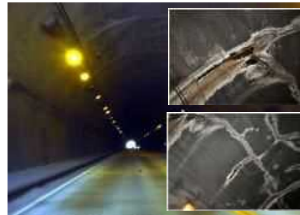
ひび割れ・漏水
