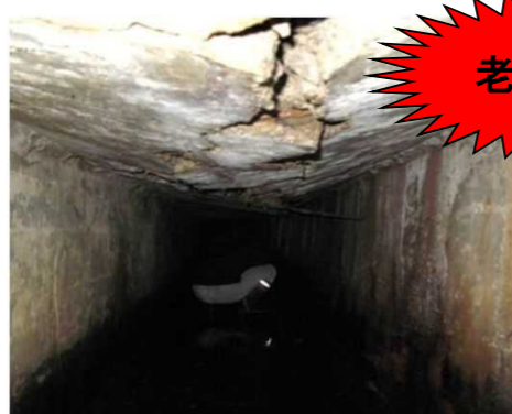
水路トンネルの天端に亀裂が発生
