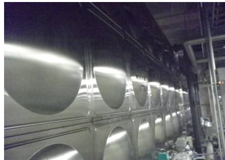
井戸水受水槽 (新館)
