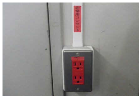
非常用コンセント
