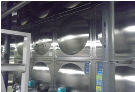
上水道受水槽 (新館)
