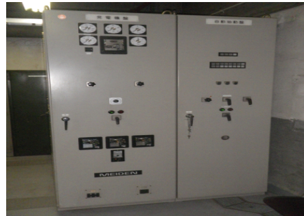
受変電設備 (本館)
