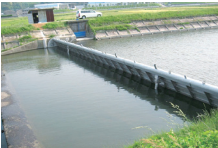
「21haの水田を潤す転倒ゲートの完成」 農業用河川工作物応急対策事業（塩屋地区）
