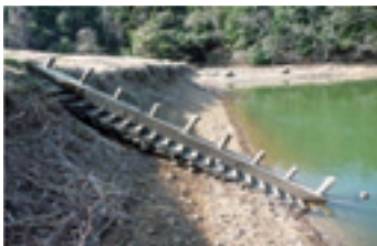
法面侵食状況
