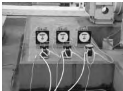
ポンプとガスメータ部
