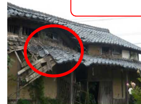
屋根材の飛散の恐れ
