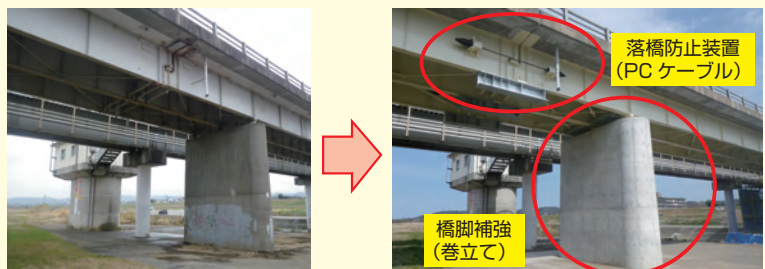
耐震性能基準を満たさない橋梁の耐震補強（大分臼杵線 高田橋）
