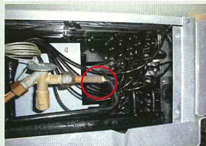
(写真)漏れ箇所
