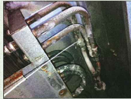
(写真) 漏れ箇所
