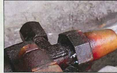
(写真)漏れ箇所
