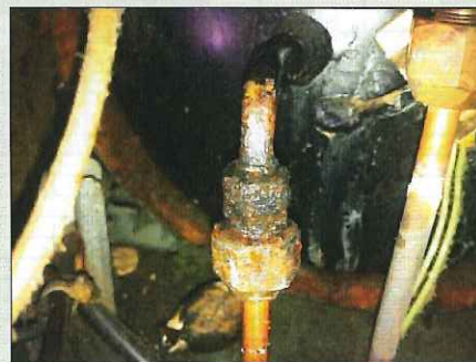
(写真)漏えい箇所
