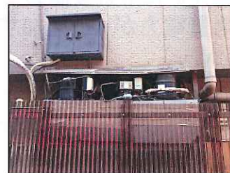
雨ざらしの室外機
